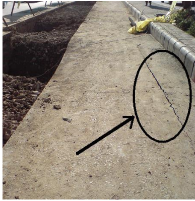
شکل (۱۰): نشست آسفالت مجاور در اثر گودبرداری در مجاور آن
